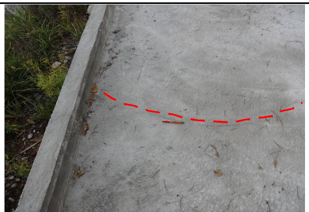
52.29K 1소단배수로 균열 CW=0.1mm
