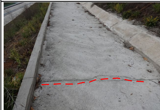
52.27K 1소단배수로 균열 CW=0.5mm
