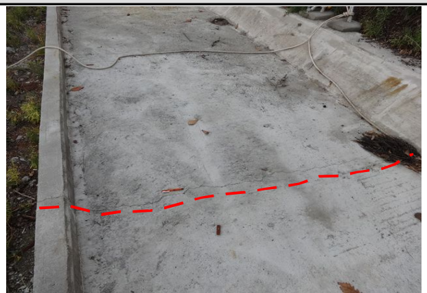
52.23K 1소단배수로 균열 CW=0.5mm
